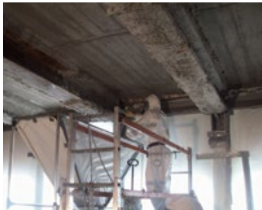
Comme partout ailleurs, la lutte pour le désamiantage dans de nombreuses constructions est une des priorités
